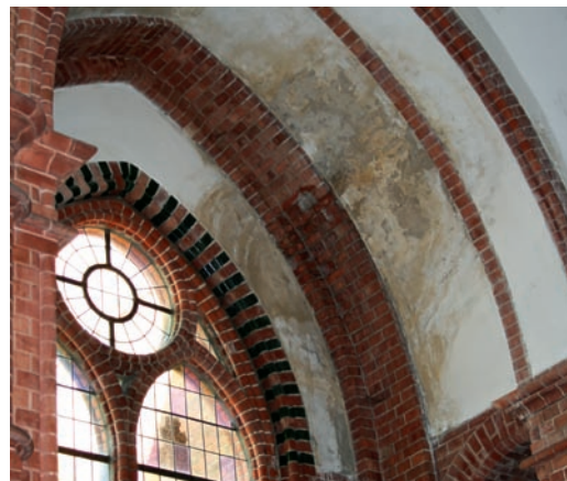
Schäden im Kircheninnern
